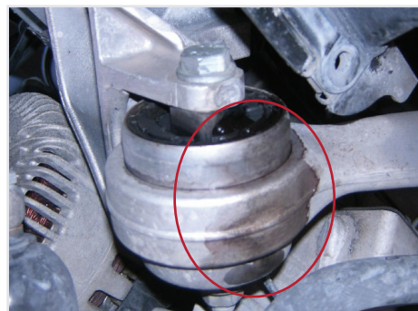
Figure 1: Fuite de liquide hydraulique au niveau du coussinet. Un indicateur d'un coussinet défectueux.
